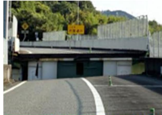
南九州自動車道(橋桁ずれ) (八代JCT～八代南IC間)
