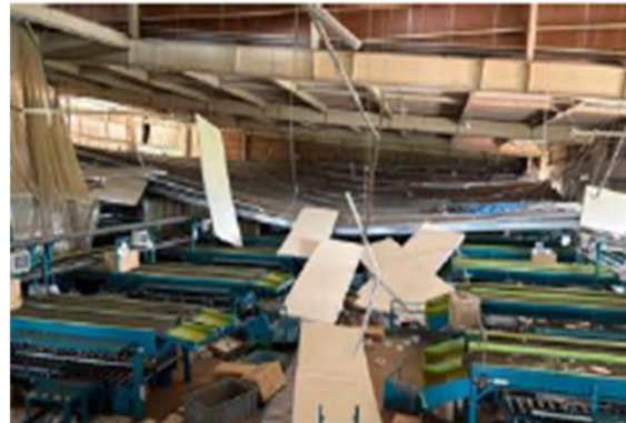
JA熊本経済連施設(施設崩壊)
