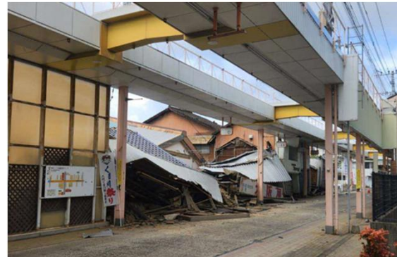
八代本町アーケード(店舗崩壊)
