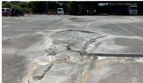
日本通運駐車場(液状化)
