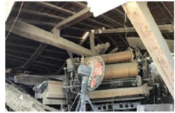
いぐさ製織作業場(施設崩壊)
