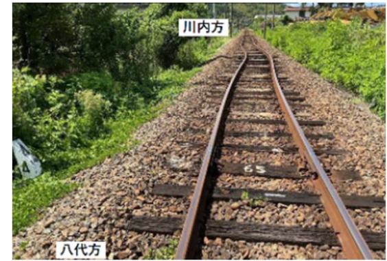
肥薩おれんじ鉄道(線路変形)
