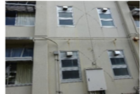
宇土中学・高校(第3棟損傷)
