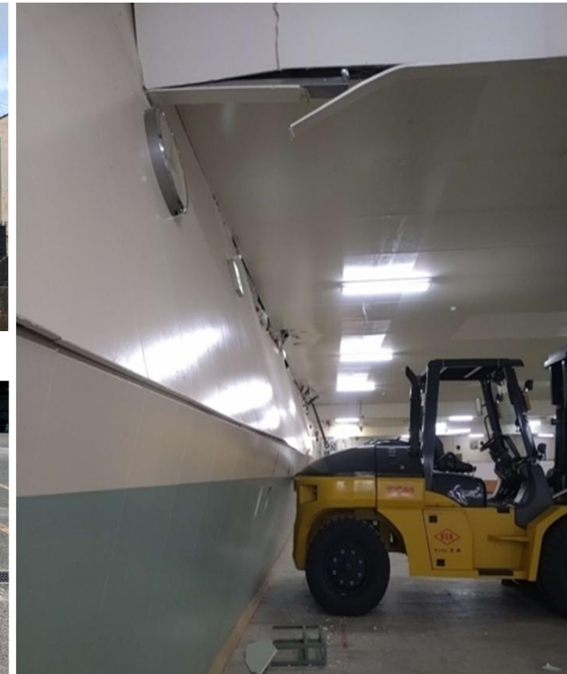
龍田紡績(内部破損)
