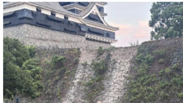
平左衛門丸石垣(石垣崩落)
