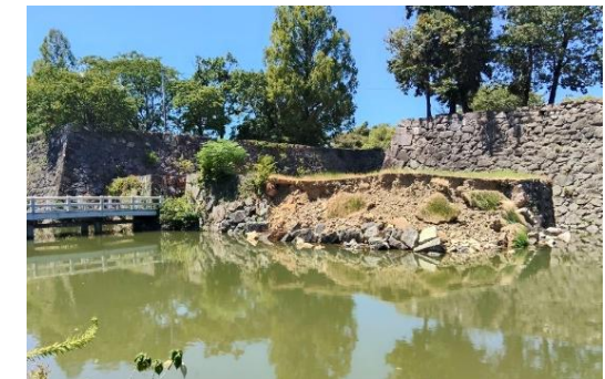
八代城跡(石垣崩落)
