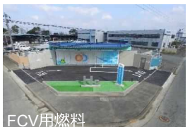
福岡酸素株式会社 水素ステーションく留米
